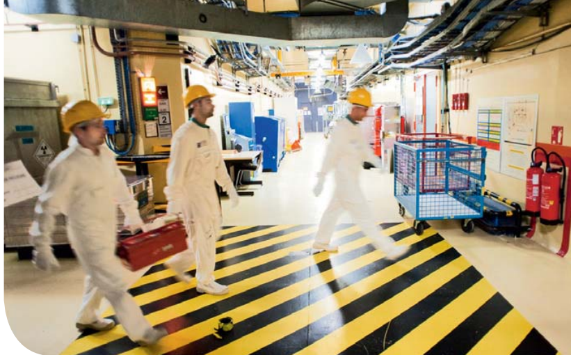
Inspection dans l'unité de production n° 1 de la centrale du Tricastin (Drôme).
