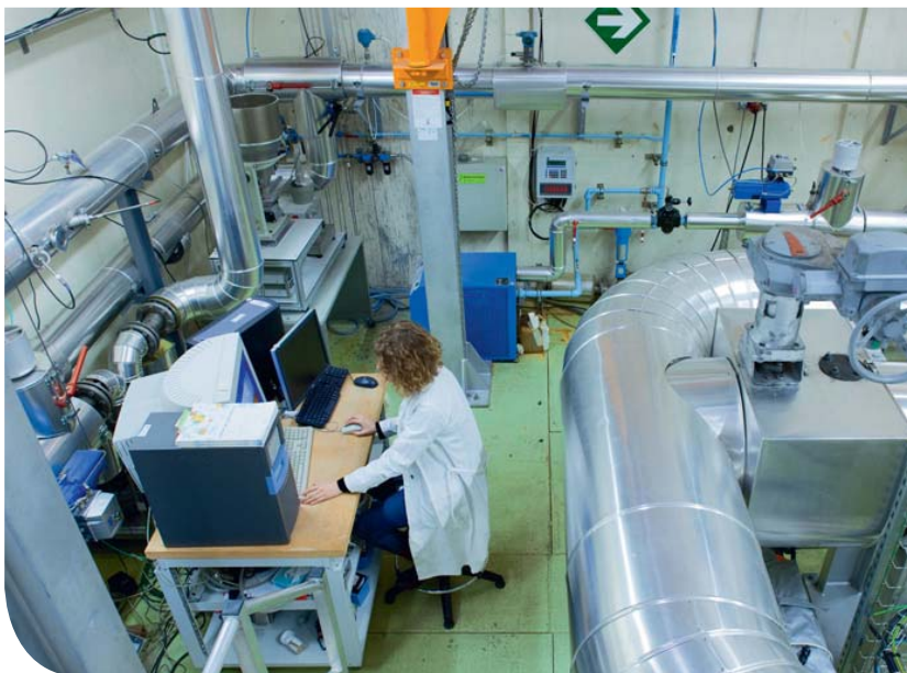
Le banc d'essai CATFISH, à Saclay (Essonne), permet d'acquérir des données analytiques sur le colmatage des filtres THE.
