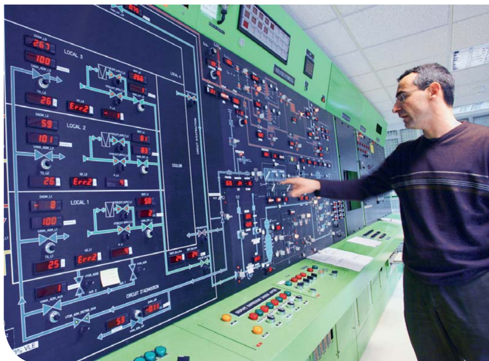
Salle de contrôle-commande de l'installation DIVA.
