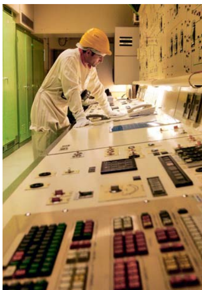
Salle de commande du bâtiment des auxiliaires nucléaires pour le traitement des effluents.
