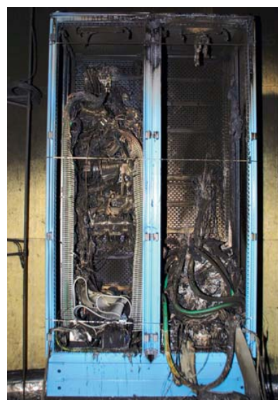
Armoire électrique après un essai PICSEL EP dans l'installation DIVA.
