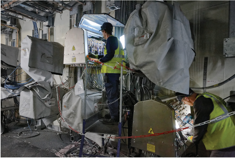
Figure 19.2. Cliché montrant des opérateurs effectuant des contrôles de câblages électriques dans le réacteur EPR Flamanville 3. Alexis Morin/Médiathèque IRSN.
