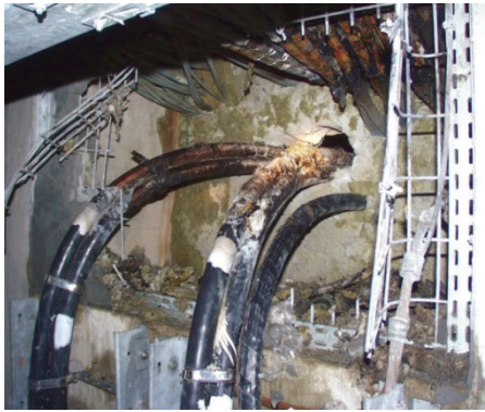
Figure 23.4. Chemins de câbles 6,6 kV après l'événement de Cattenom 2 du 16 mai 2004. EDF.
