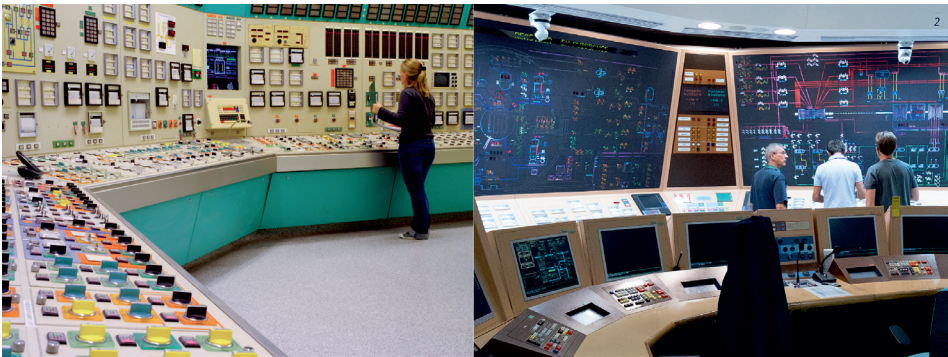
Figure 16.1. À gauche, vue d'une salle de commande conventionnelle (centrale nucléaire de Fessenheim). Médiathèque EDF – Mario Fourmy; à droite vue d'une salle de commande informatisée d'un réacteur du palier N4 (centrale nucléaire de Civaux). Romain Beaumont photographies.
