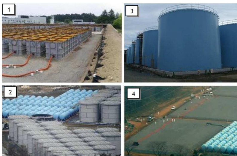
Source TEPCO - 1/ réservoirs cubiques soudés - 2/ réservoirs verticaux à assemblages par brides boulonnées et réservoirs horizontaux soudés - 3/ réservoirs verticaux soudés - 4/ réservoirs enterrés
