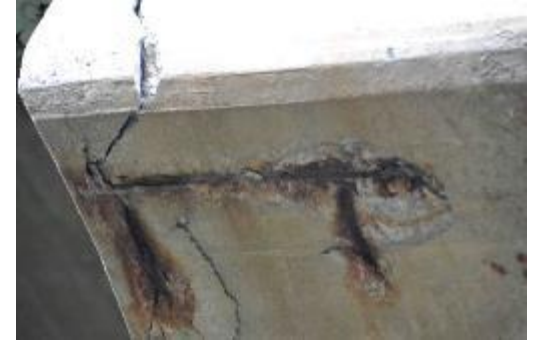
Illustration de la corrosion d'armatures
