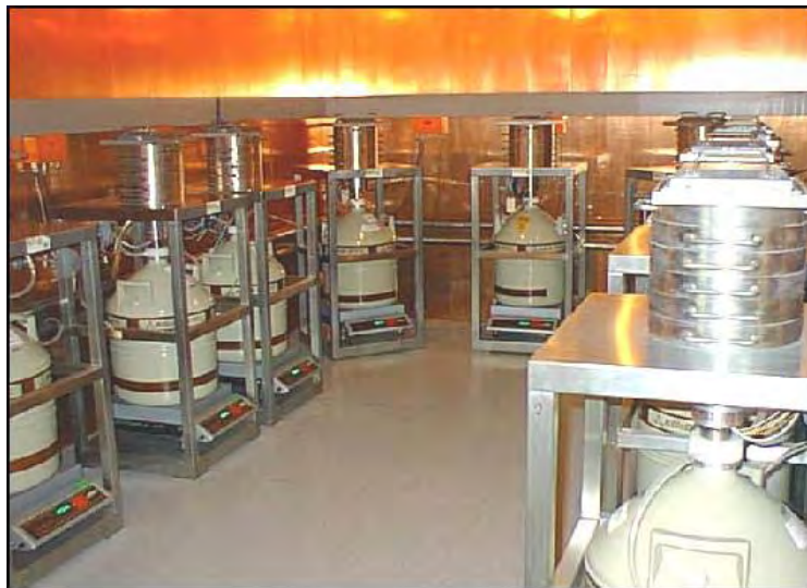
Figure 9 - Salle de spectrométrie gamma du Laboratoire de mesure de la radioactivité de l'environnement (LMRE) à Orsay, installée dans une enceinte blindée et implantée sous une dalle de 3 m de béton boré (10 m équivalent eau).
