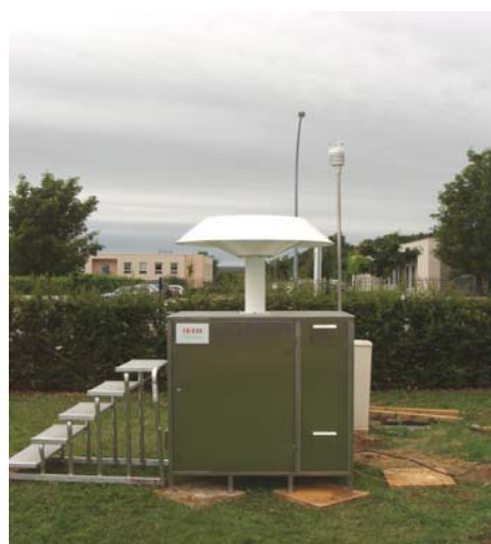
Réseau OPERA-Air de l'IRSN : station de collecte d'aérosols à très grand débit (TGD) (site de Dijon)
