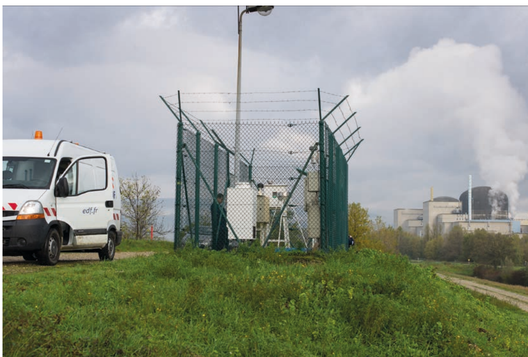
Station « AS1 » équipées de différents dispositifs de prélèvements et de mesure pour la surveillance de l'environnement, située à 1 km sous les vents dominants du CNPE de Saint-Albans-Saint-Maurice.
