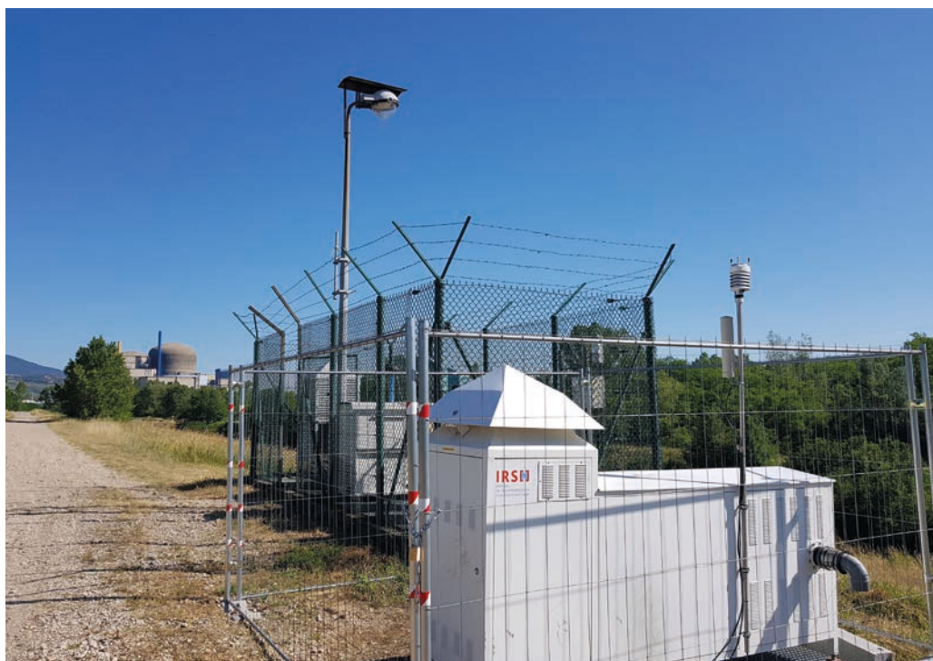
FIGURE 2 / STATION DE COLLECTE D'AÉROSOLS GRAND DÉBIT IRSN AU POINT DE SURVEILLANCE SUD DU CNPE DE SAINT-ALBAN/SAINT-MAURICE
