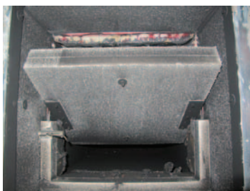
Figure 24. Photographie d'un clapet coupe-feu pouvant être altéré lors de pics de pression.
