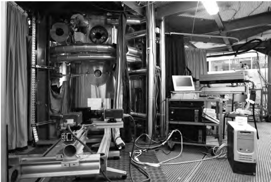
Figure 39.5. Vue de l'installation TOSQAN. Olivier Seignette/Mikaël Lafontan/Médiathèque IRSN.
