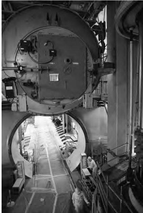
Figure 30.1. Ouverture du tampon d'accès matériels (TAM) lors d'une visite décennale de la centrale nucléaire de Fessenheim. Noak/Le bar Floréal/Médiathèque IRSN.
