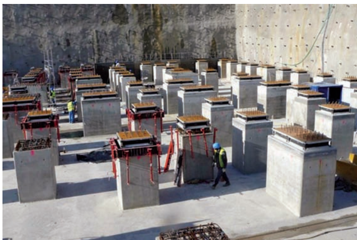
Figure 7.11. Vue, lors de la construction du réacteur Jules Horowitz (2009), des plots avec leurs patins antisismiques, d'après Le Blog des Énergies. © DR.
